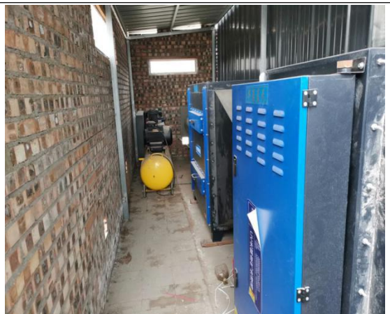
有机废气治理设施
